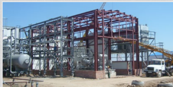
Здание компрессорной UNIT-1200 Месторождения западной части Бортового лицензионного участка Саратовской области.
