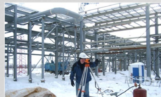
Предприятие комплексной подготовки газа и газового конденсата поселок Карпенко Саратовской области.
